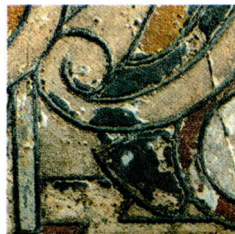
Slijtage van de beschikking en de oppervlaktelaag Herkoliersstraat 35, Koekelberg
