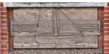
Details van geveldecor op woningen in de Rotterdamstraat en de Scheldestraat, arch. J. Diongre. (A. de Ville de Goyet © GOB)
