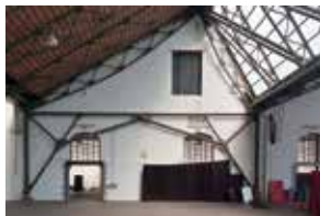
Detail van het scharnierende gebinte van de sheddaken. (A. de Ville de Goyet © GOB)
