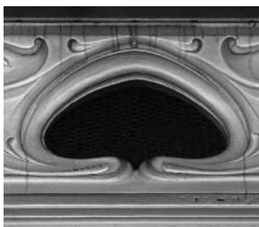
Verluchtungskoker van het oude verwarmingssysteem.
