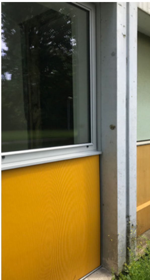
AFB. 17 Het raamkader in gepoedercoat staal sluit visueel nauw aan bij de originele raamkaders in aluminium (© MAKER architecten).
