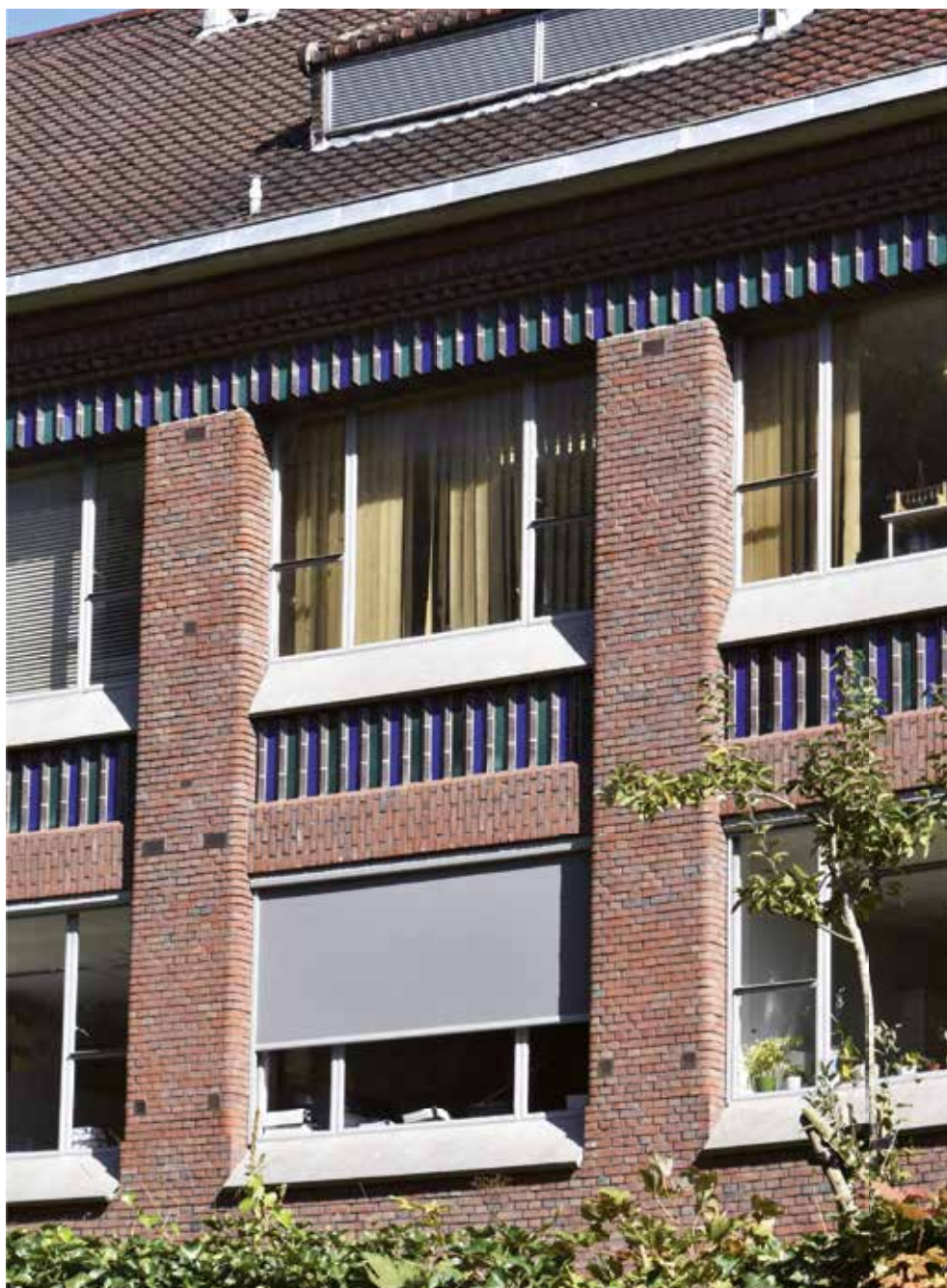
AFB. 8 Geneeskundige Stichting Koningin Elisabeth, Jean Joseph Crocqjlaan, 3 te Laken (1927-1930), arch. Henry Lacoste. Let op de ventilatieopeningen in de gevelmuren. De kleine roosters geven uit onderin de ruimten, de grote ter hoogte van de plafonds (© ARCHistory / APEB, 2018).
