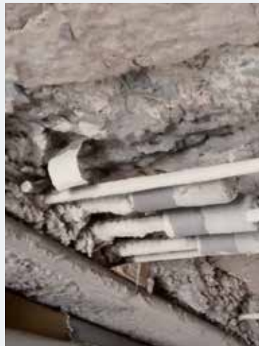
Afb. 17 Vernieuwing van de wapeningen en verbinding van de oude en nieuwe wapeningen door middel van moffen (2015 © Origin).
