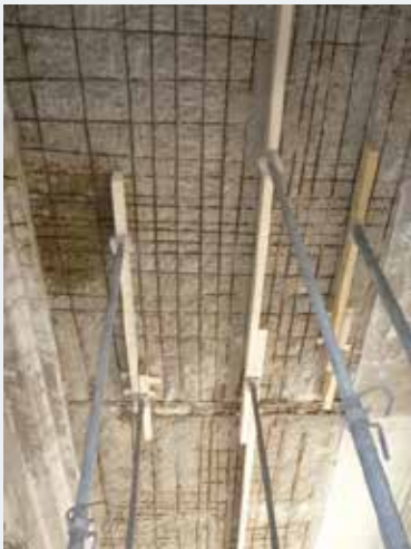
Afb. 16 Decapering van loszittend beton, zichtbare verroeste wapeningen (2015 © Origin).
