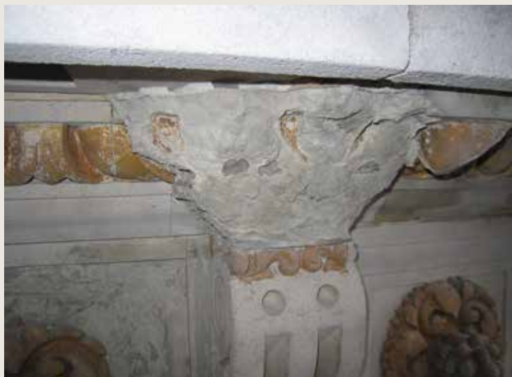
De Swane. Verpulvering van een console (Avendersteen?) (© CHE, 2008).
