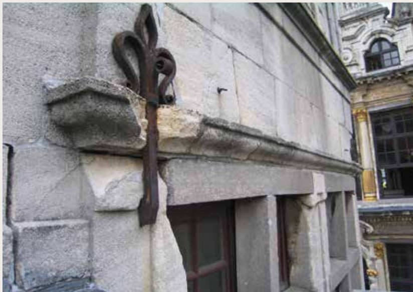
De Heert . Gebroken Euvillesteen ten gevolge van de corrosie van een metalen gevelanker (©CHE, 2000).
