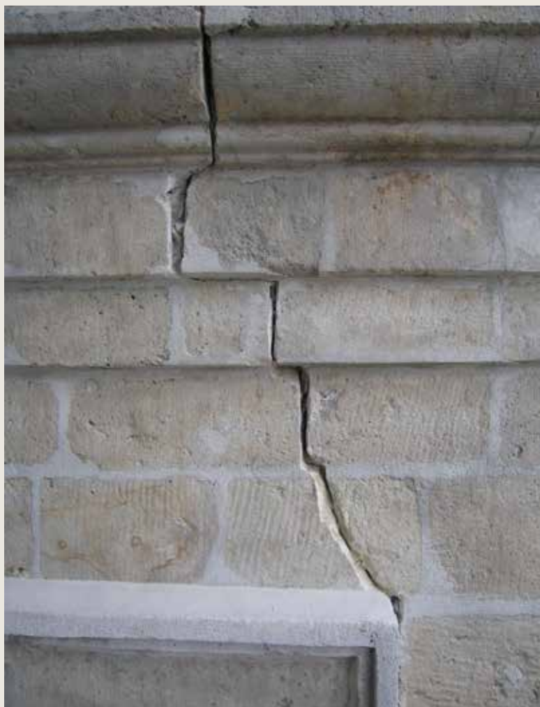
De Swane. Barst in de oorspronkelijke gevelbekleding in Balegemse steen (© CHE, 2008).
