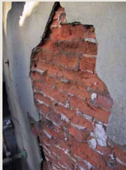
De Vos. Afgebrokkelde bepleistering van de linkse mandelige muur (© CHE, 2014).
