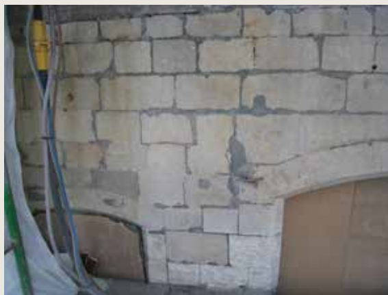
Het Brouwershuis. Cementen voegen aangebracht tijdens vroegere werken. (© CHE, 2008).
