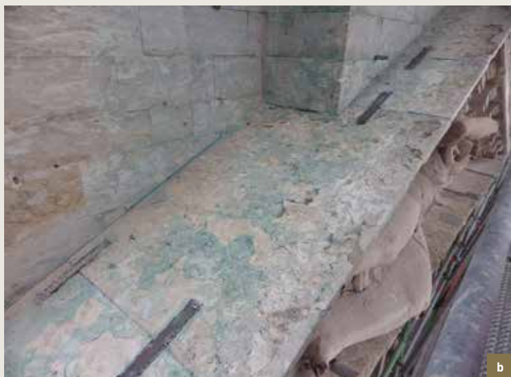
De Wolvin . Detail van de onderdelen van een fronton in Gobertangestein. Afschilfering. a) voorkant met zichtbaar wordende bioturbaties van de steen; b) bovenaanzicht van het fronton waar steenaafschilfering zichtbaar werd na het verwijderen van de loden slab [© CHE, 2014].
