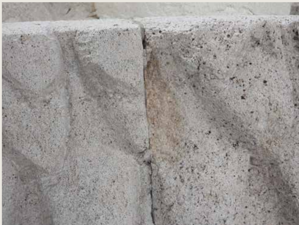
Den Horen. Afgeschilferd en gebarsten element in Euvillesteen (© CHE, 2014).
