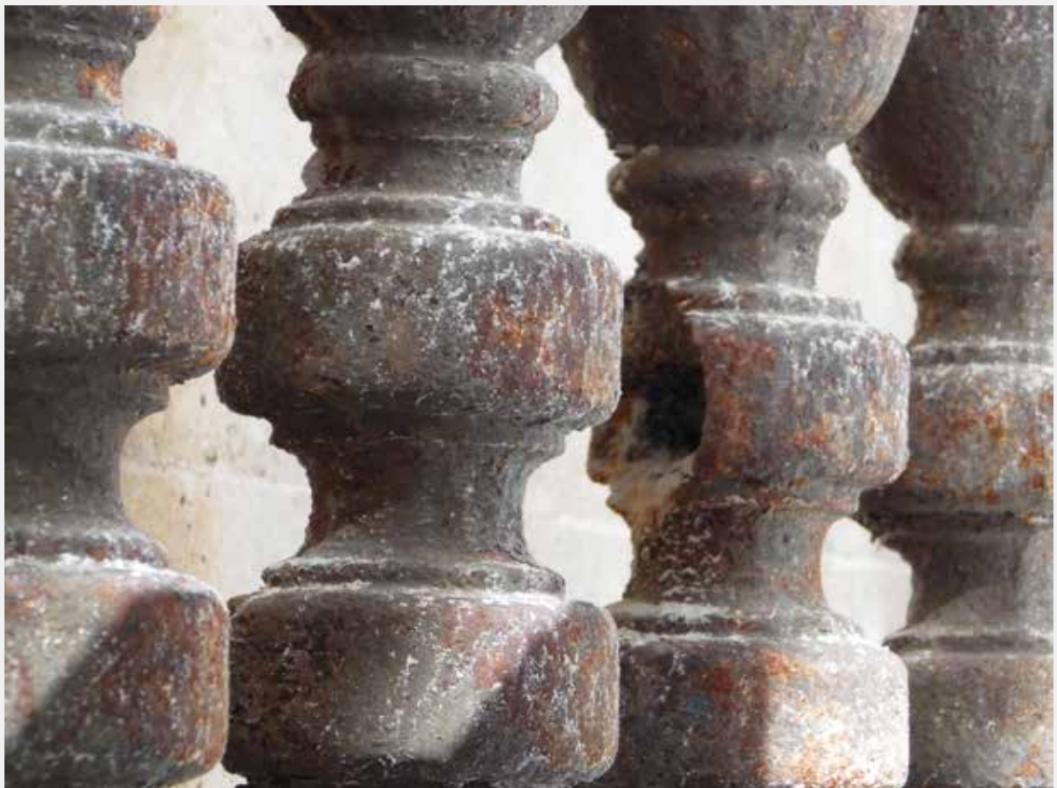
Den Sack. Corrosie van metalen balusters, op sommige plaatsen is het materiaal volledig weggevreten (© CHE, 2014).
