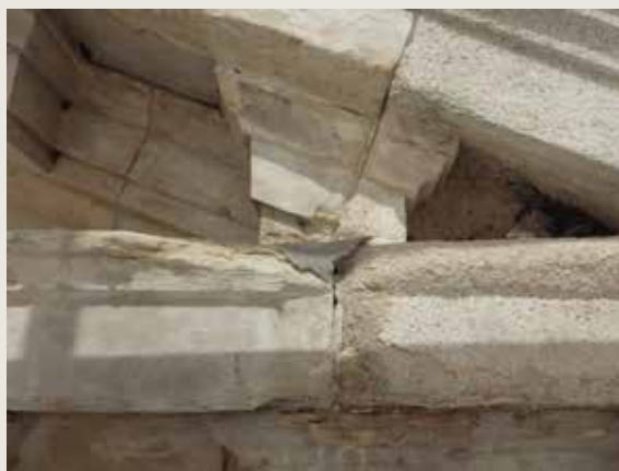
De Wolvin. Verpulverende delen van het fronton in Gobertange- (links) en Euvilliesteen (rechts) (© CHE, 2014).
