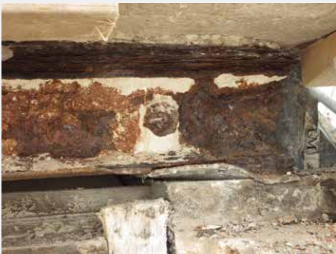
Het Vosken en Den Eycke. Corrosie en roestexpansie van een metalen latei (© CHE, 2014).
