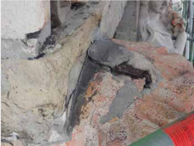
De Vos. Corrosie van een metalen bevestigingsklauw van een beeld op de topgevel; dit veroorzaakte het afbreken van het beeld (© CHE, 2014).
