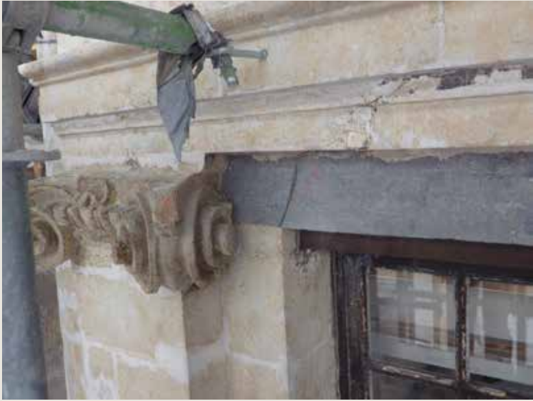
De Duive. Barst in de hardstenen latei veroorzaakt door roestexpansie van de metalen latei (© CHE, 2012).
