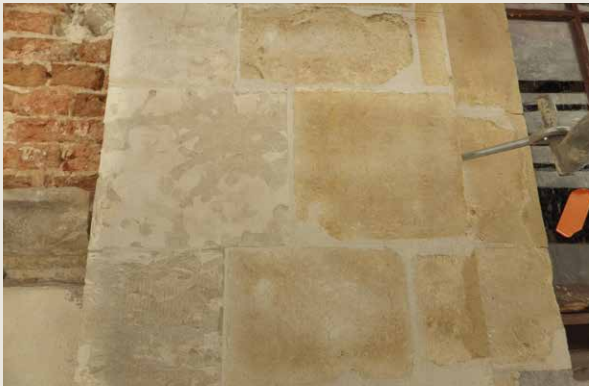
Den Helm en Den Pauw. Detail van de gevelbekleding na reiniging, met enerzijds Gobertangestein (links) en anderzijds Balegemse steen (rechts) op de gevel van Den Helm . Uiterst links is het bakstenen metselwerk van Den Pauw te zien dat vrijkwam na het afbikken van de niet hechtende bepleistering (© CHE, 2015).
