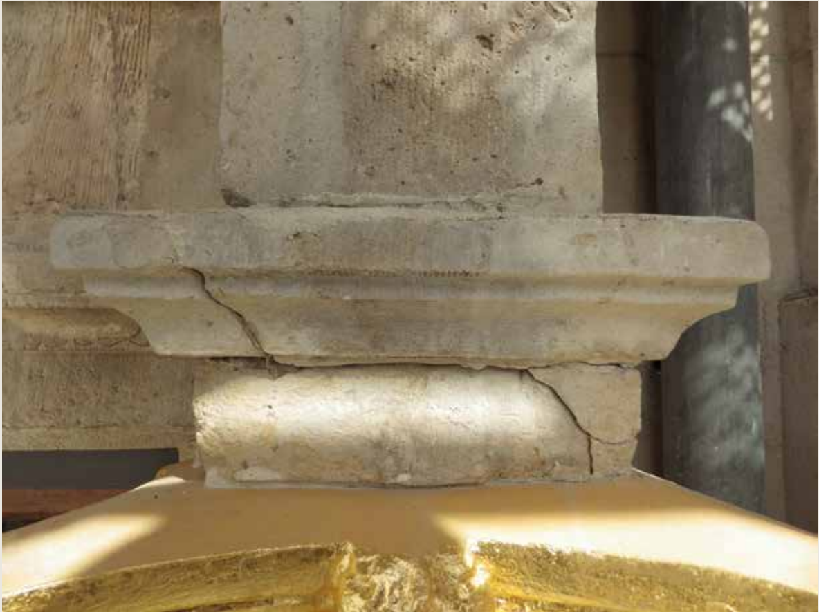
Den Cruywagen. Barst in de oorspronkelijke gevelbekleding in Balegemse steen (© CHE, 2014).
