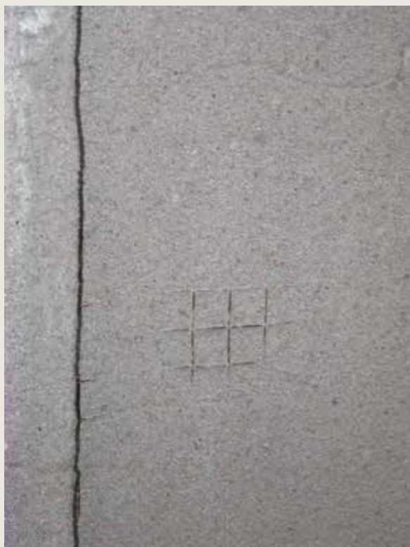
De Gulden Boot. Het metalen armatuur, met vierkante mazen en sporen van roest, komt aan de oppervlakte van de cementen bepleistering (© CHE, 2008).
