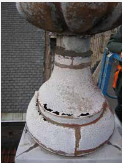
De Roose. Detail van een zinken vaas aangetast door corrosie (© CHE, 2000).
