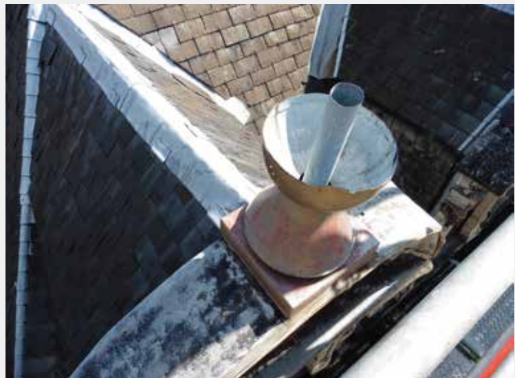
Het Vosken en Den Eycke. Een door corrosie gebroken zinken vaas (© CHE, 2015).
