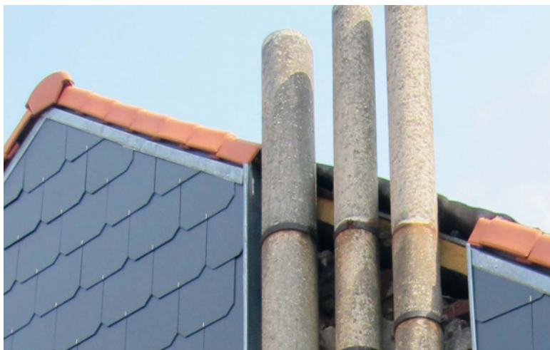
Fig. 19 Pose correcte du bardage, mais un espace non refermé subsiste entre la charpente et la maçonnerie derrière les conduits de cheminée ! (photo de l'auteur).
