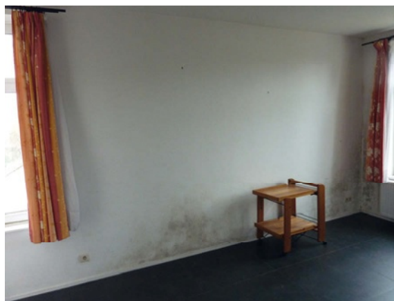
Fig. 2 Développement de moisissures dans une cure rénovée, suite à la pose de nouveaux châssis et de double vitrage en l'absence d'un système de ventilation (© CSTC).
