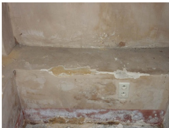
Fig. 1 Efflorescences de sels et dégradation des matériaux dans une cave ventilée et chauffée (© CSTC).
