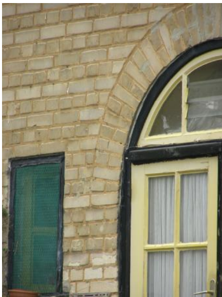
De foto P6050007 van het huis nr. 3 aan de Tuberozenstraat toont dat de cirkelboog intact gebleven is. Hier werd het schrijnwerk ingepast in de cirkelboogvorm.
