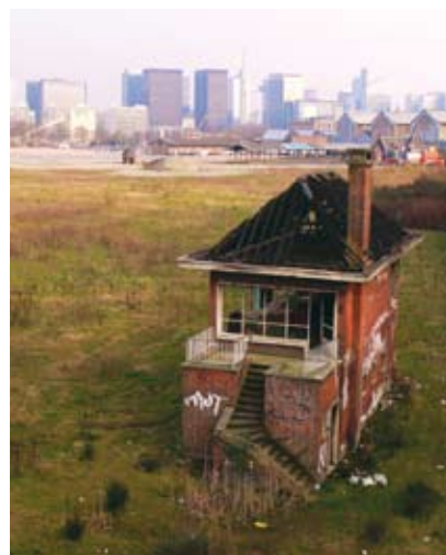
Paysage urbain de la zone de Tour et Taxis à Bruxelles : une problématique patrimoniale que la charte de Venise ne peut guère seule instruire.
