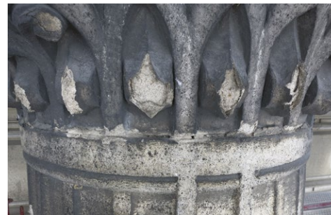
Dégradations du chapiteau en pierre d'Euville, 2013*.
