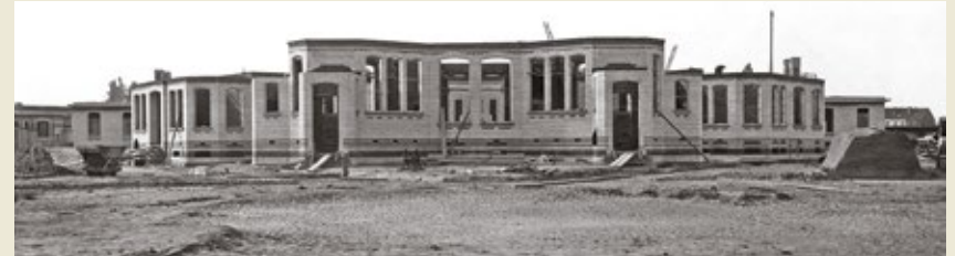
Le pavillon de consultation des adultes en construction, tel qu'il apparaissait dans l'axe de l'entrée. (photo R.V.Duquenne, ACPASB)
