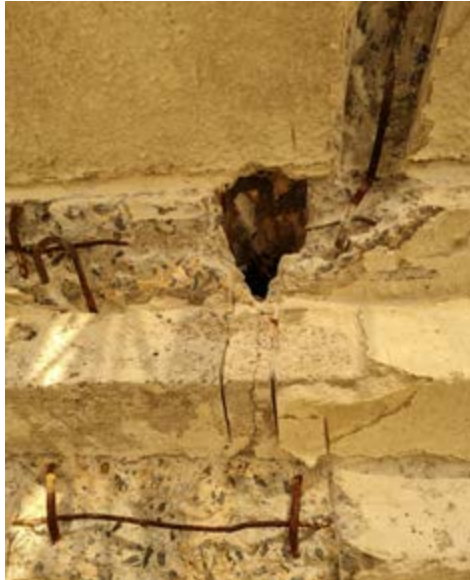
FIG. 2 Etat de dégradation des bétons au niveau des toitures (© Árter, 2020).
