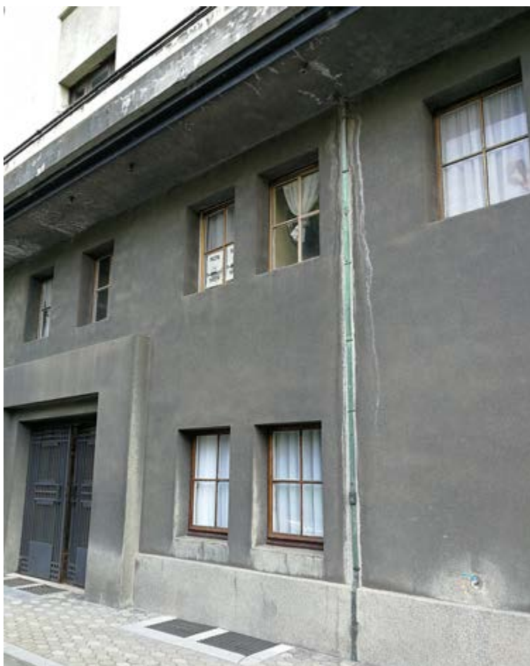
FIG. 3A Socle en granito poli avant restauration (© Árter, 2018).
