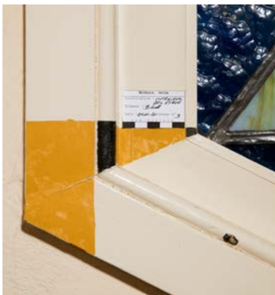
FIG. 9 Intérieur, détail de sondage, cage d'escalier, fenêtre de dégagement avec la finition d'origine de l'encadrement du vitrail, Étude des finitions décoratives des espaces intérieurs , 2020 (© KIK-IRPA).
