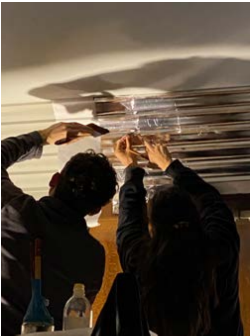
FIG. 7A La salle à manger. La restauration du décor en feuille aluminium de la corniche en cours (© Atelier d'architecture CAZ sc sprl).
