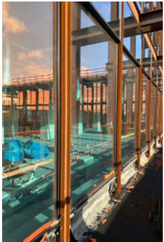
FIG. 6D Les vitrages des façades sont remplacés par du double vitrage plus performant avec le même effet esthétique réfléchissant cuivré (J.-M. Basy, 2022 © urban.brussels).
