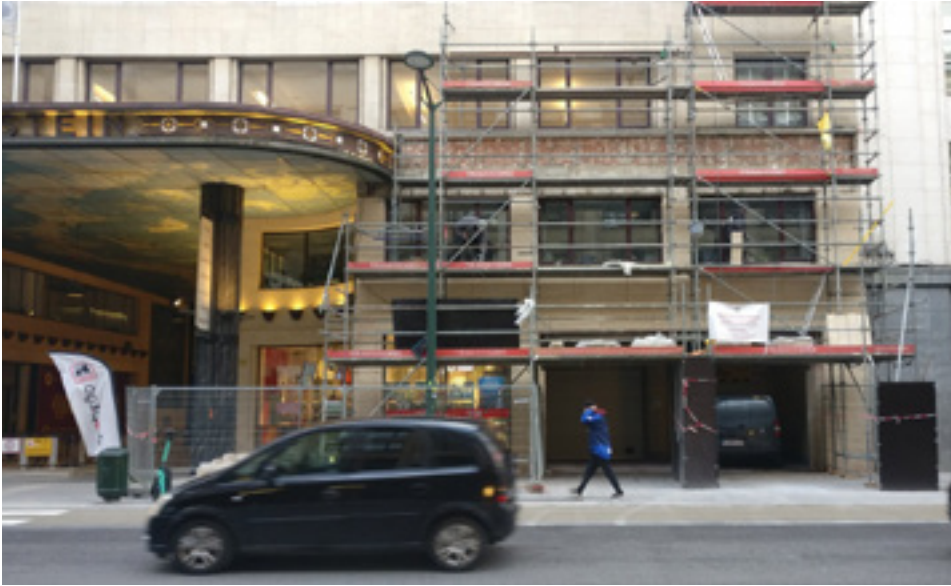
FIG. 2A La façade de la galerie Ravenstein côté Cantersteen avec les plaques de revêtement en travertin enlevées (P.-Y. Lamy, 2022 © urban.brussels).
