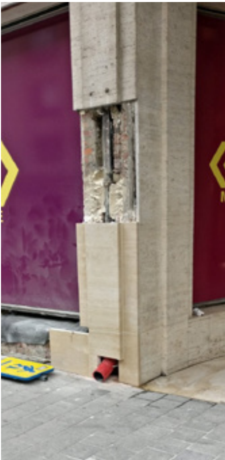
FIG. 2B Les plaques en travertin présentaient de nombreux défauts (P. Y. Lamy, 2021 © urban.brussels).
