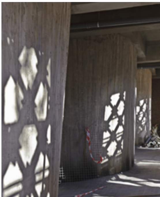
FIG. 1 Halte Congrès. Les impressionnantes cheminées de ventilation en béton cachées par les claustras (A. de Ville de Goyet, 2016 © urban.brussels).
