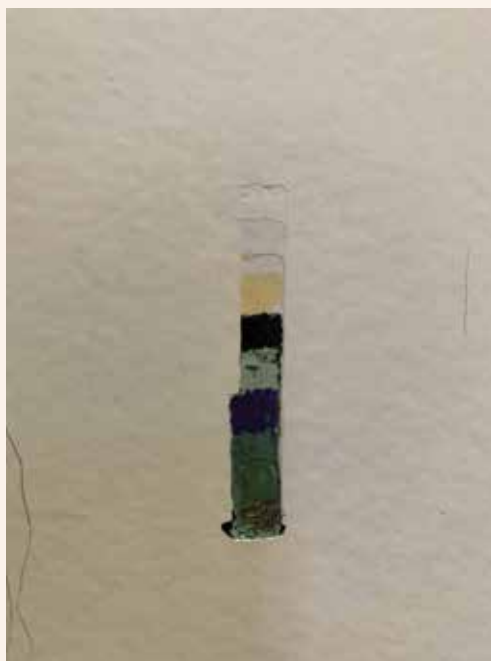
FIG. E.4.2 Rue de la Seconde Reine 5, Uccle, sondages sur la porte du hall d'entrée (© M. Minnecci, 2020).
