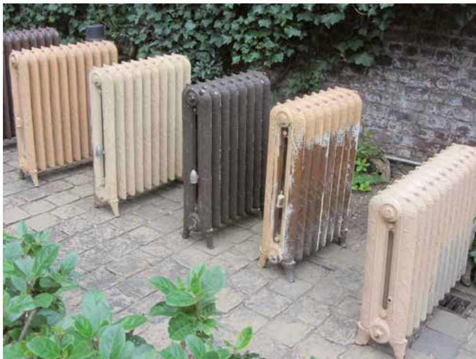
Radiateurs avec purgeurs d'air cloche possédant un obturateur d'air dilatable sous l'action de la chaleur (photo de l'auteur).
