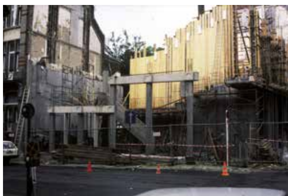
Fig. 12 Les colonnes du rez-de-chaussée de la façade à rue en construction, 1988-1989 (© AUCL, Faculté LOCI/Fonds Jean Cosse).
