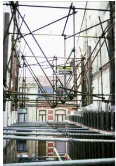
Fig. 3 Étañonnement du mur mitoyen côté rue d'Irlande, 1988 (© AUCL, Faculté LOCI/Fonds Jean Cosse).
