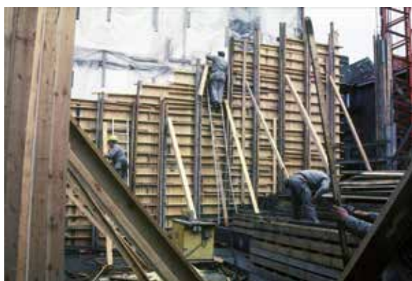
Fig. 14 Coffrages du voile en béton contre le mur mitoyen côté rue d'Irlande, 1989 (© AUCL, Faculté LOCI/Fonds Jean Cosse).
