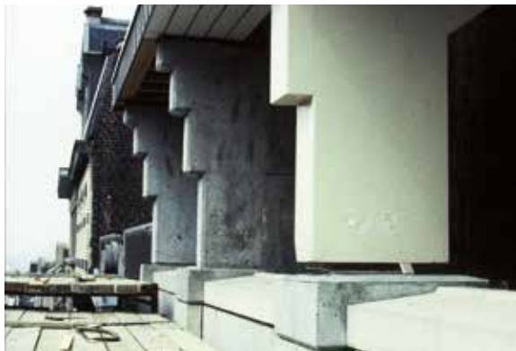
Fig. 21 Détail des appuis de la charpente et de la corniche, 1989 (© AUCL, Faculté LOCI/Fonds Jean Cosse).
