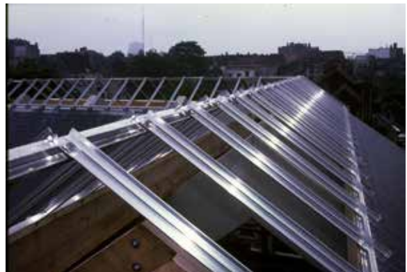
Fig. 22 La structure en aluminium pour le lanterneau faitier, 1989 (© AUCL, Faculté LOCI/Fonds Jean Cosse).
