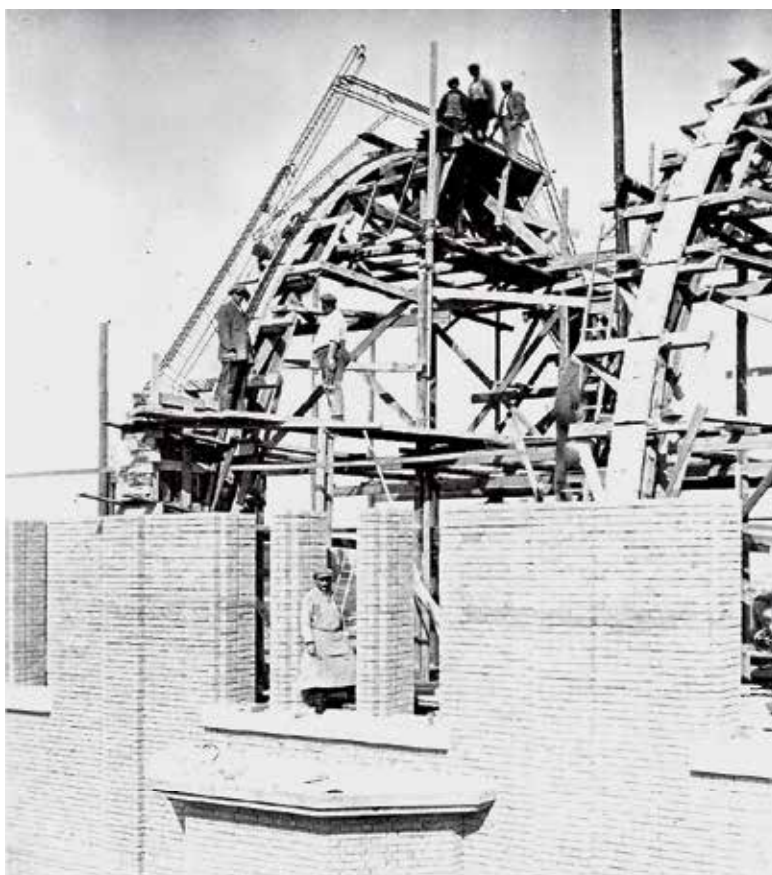
Fig. 13 Construction de l'église du Divin Sauveur à Schaerbeek (1935) : les ouvriers prennent la pose alors qu'ils sont occupés à mettre en place les armatures de la première ferme de la charpente (© Archives de la fabrique d'église du Divin Sauveur).
