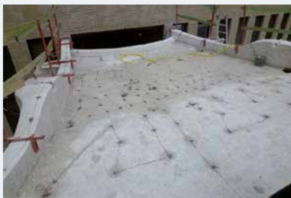
Fig. 22 Anodes sacrificielles en cours de placement via la face supérieure et connectées aux armatures (2015 © Origin).
