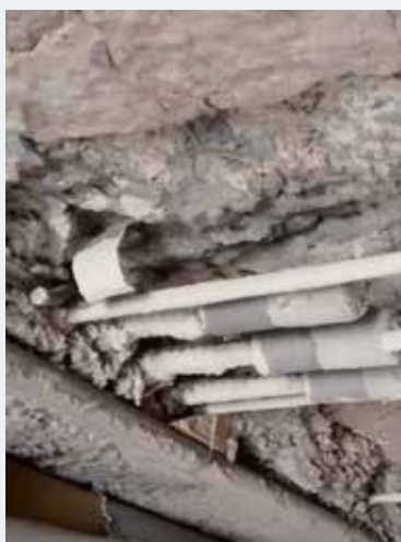
Fig. 17 Renouvellement des armatures et liaison des anciennes et des nouvelles armatures à l'aide de manchons (2015 © Origin).
