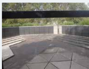
Fig. 12 Salissures et encrassement visibles (2018 © Origin)
