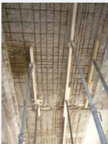
Fig. 16 Décapage des bétons non adhérents, armatures rouillées visibles (2015 © Origin).
