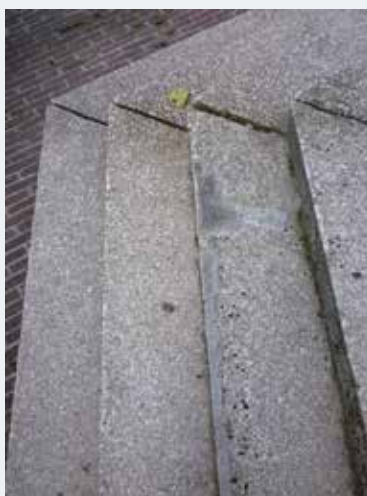
Fig. 8 Marches, avant travaux, ancienne réparation visible (2009 © Origin).
