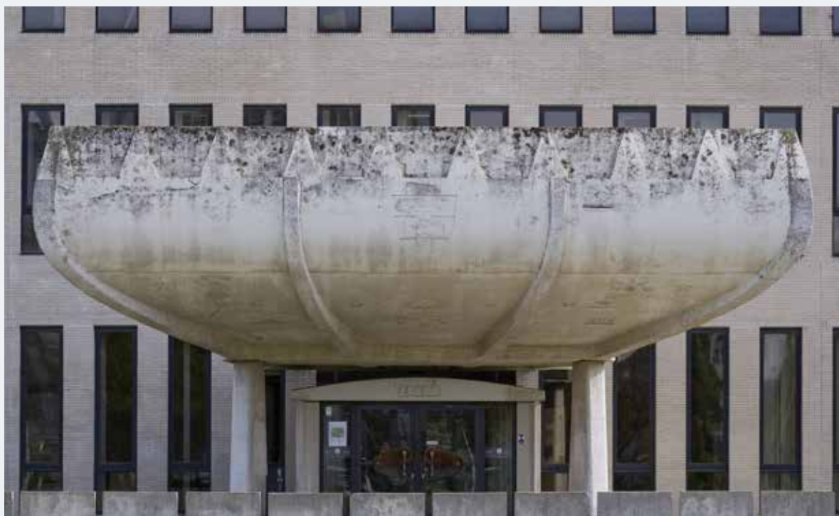
Fig. 21 Auvent du bâtiment M de la VUB : avant les travaux, en 2011, présence de mousses (© Origin).
