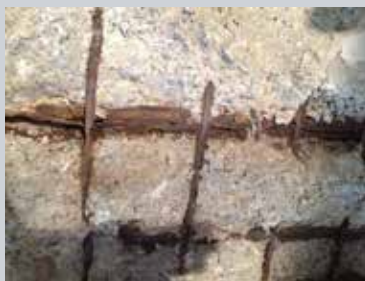
Fig. a Corrosion des armatures mises à nu avec perte significative de matière (2017 © Origin)
