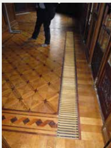
Fig. 11 Intégration du chauffage par le sol dans le parquet en bois (E. de Sart, 2015 © urban. brussels).
