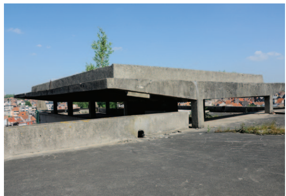
Fig. 10 Sur le toit, des bassins en béton prévus pour la récupération de l'eau de pluie (A. de Ville de Goyet, 2015 © SPRB).
