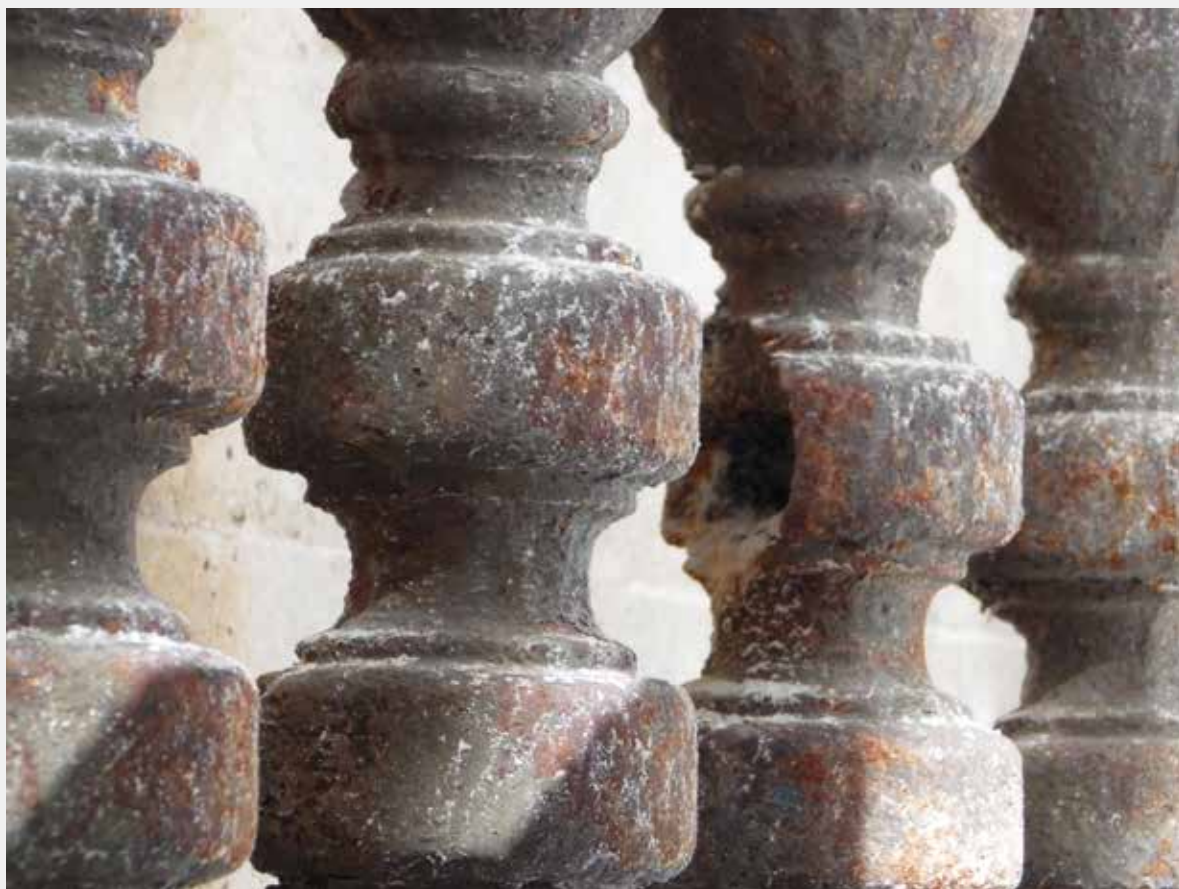
Le Sac. Corrosion des balustres métalliques allant jusqu'à l'absence totale de matière (© CPH, 2014).
