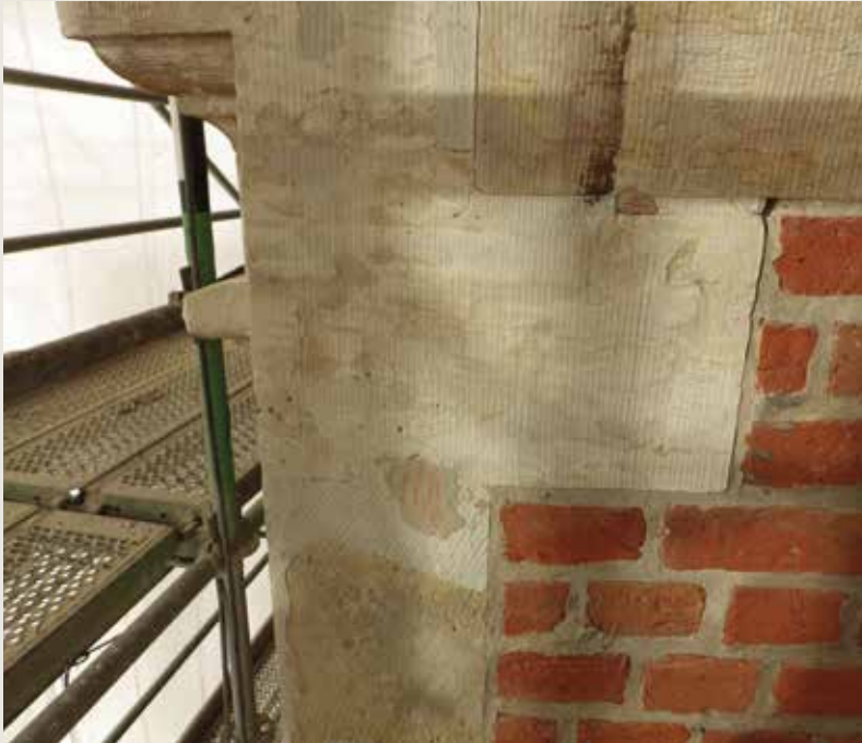
Façade latérale de la maison Le Heaume . Détail du parement d'angle avec en haut de la pierre de Gobertange, en bas de la pierre de Balegem, et à droite, de la maçonnerie de brique. À noter, l'aspect orangé de la pierre supérieure, dû à la présence du fer dans la glauconite contenue dans la pierre (© CPH, 2014).
