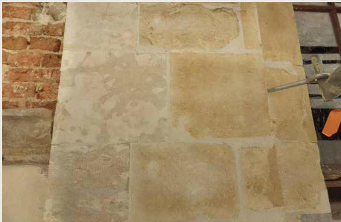
Le Heaume et Le Paon . Détail du parement après nettoyage montrant, d'une part, le parement en pierre de Gobertange (à gauche) et en pierre de Balegem (à droite) de la façade Le Heaume . À l'extrême gauche, on voit apparaître, suite au dérochage des enduits non adhérents, la maçonnerie de brique de la façade de la maison Le Paon (© CPH, 2015).
