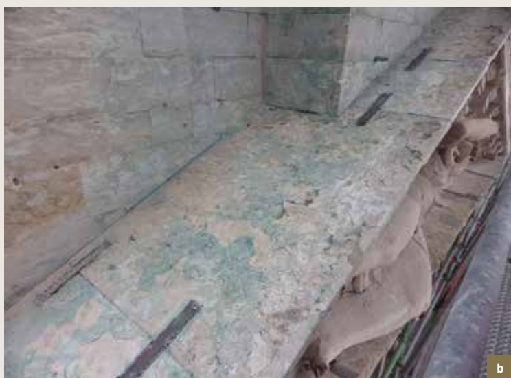
La Louve . Détail des éléments du fronton en pierre de Gobertange. Desquamation. a) vue de face avec apparition des bioturbations de la pierre ; b) vue du dessus du fronton avec pierre desquamée visible suite à l'enlèvement du recouvrement en plomb (© CPH, 2014).
