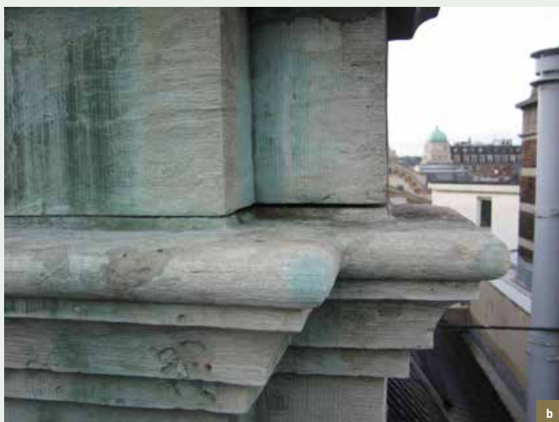
La Brouette. Partie supérieure de la façade. Coulées vertes dues à l'oxydation des décorations en cuivre. a) vue d'ensemble ; b) détail des coulées sur la pierre de Gobertange (© CPH, 2014).
