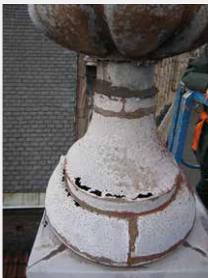
La Rose. Détail d'un vase en zinc corrodé et troué (© CPH, 2000).
