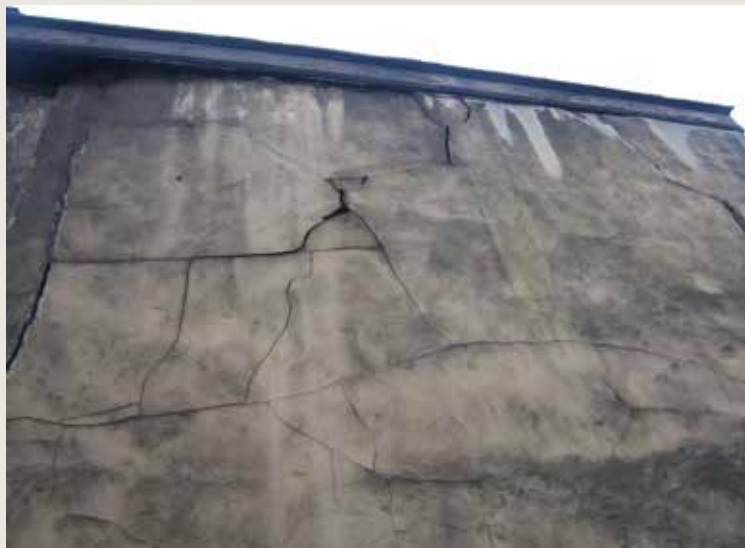
Le Cygne. Décollement de l'enduit du mur mitoyen, à droite (© CPH, 2008).
