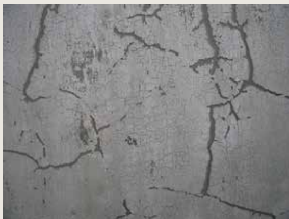
Le Mont Thabor. Façade latérale. Faïençage de l'enduit et écaillage de la peinture (© CPH, 2014).
