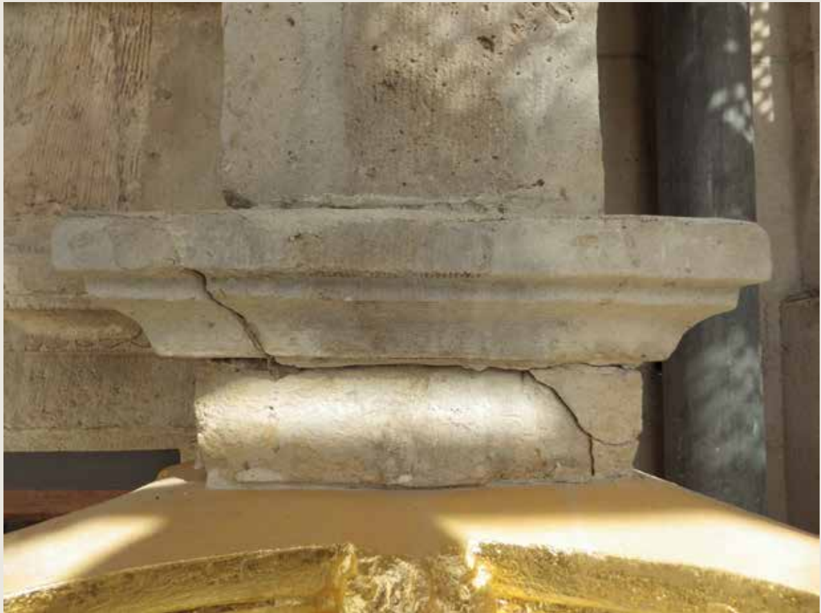
La Brouette . Fissure dans le parement d'origine en Balegem (© CPH, 2014).
