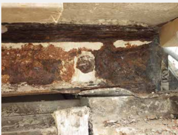
Le Petit Renard et Le Chêne. Corrosion et expansion de rouille d'une poutrelle métallique (© CPH, 2014).
