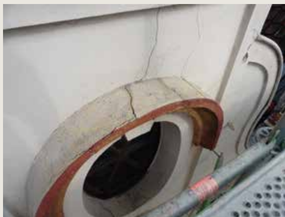
Le Paon. Faïençage de l'enduit (© CPH, 2014).
