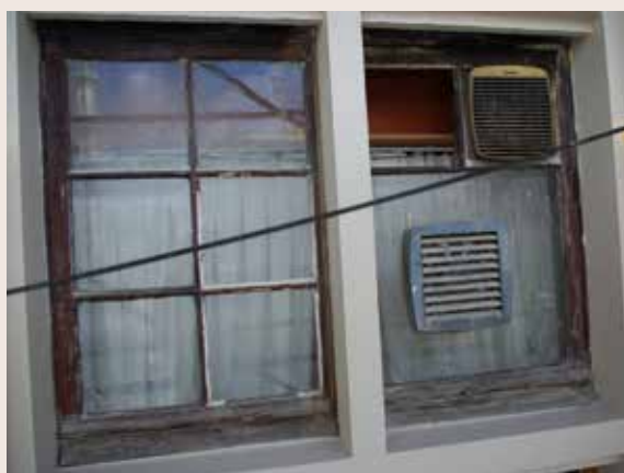
La Chaloupe d'Or . Deux châssis avec rejets d'eau et pièces d'appui dégradés. Les châssis ont été modifiés dans le temps pour intégrer des ventilations de manière aléatoire (© CPH, 2014).
