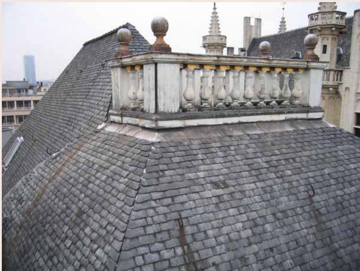
Le Cygne . Terrasse en bois du belvédère. Éléments déboîtés. Parties inférieures dégradées. Manque d'entretien généralisé (© CPH, 2008).
