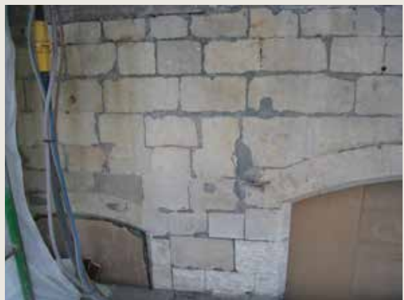
La Maison des Brasseurs. Joints au ciment réalisés lors de travaux précédents (© CPH, 2008).
