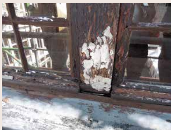
Le Petit Renard et le Chêne . Un châssis fortement dégradé (© CPH, 2014).
