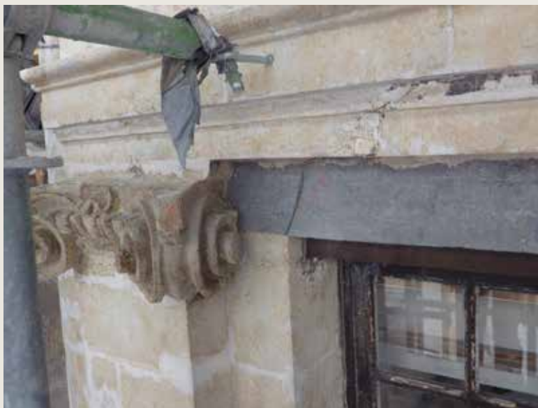
Le Pigeon . Fissure dans le linteau en pierre bleue suite à l'expansion de la rouille du linteau métallique (© CPH, 2012).
