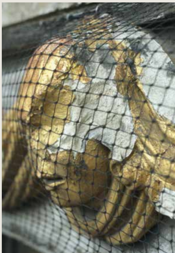
La Rose. Élément sculpté pulvérulent (pierre d'Avesnes?). Un filet a été placé provisoirement pour éviter la chute de l'élément (© CPH, 2000).
