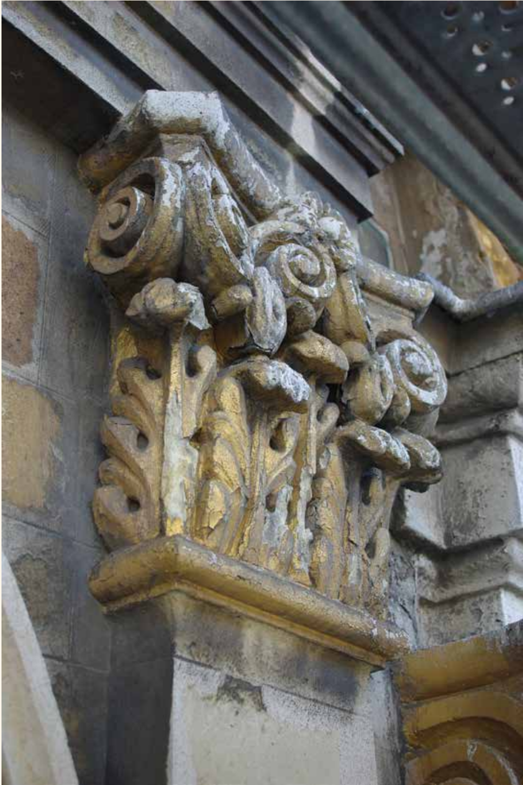
Le Pigeon . Détail d'un chapiteau composite. Épaufiture de la pierre entraînant la dégradation de la dorure. Usure générale de la dorure, encrassement (© CPH, 2012).
