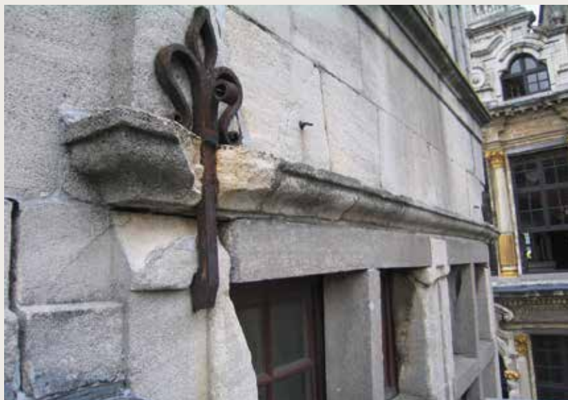
Le Cerf. Pierre d'Euville cassée suite à la corrosion d'un ancrage métallique (© CPH, 2000).
