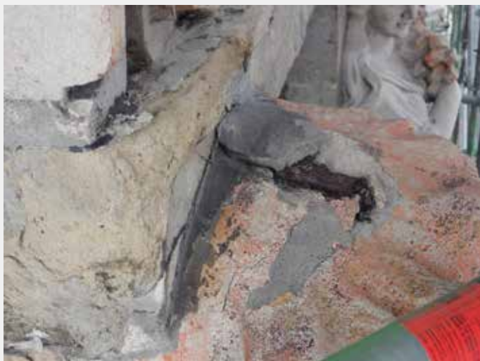
Le Renard. Corrosion d'une patte métallique de fixation au sommet d'une statue entraînant la cassure de celle-ci (© CPH, 2014).
