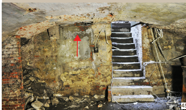
44-45 Vue sur le mur du fond de la cave à l'aplomb du mur gouttereau sud de la maison. Une ancienne lunette permettait d'accéder à la cave depuis l'extérieur de la maison. Elle a été bouchée à l'occasion de la construction de l'escalier actuel (US 1063), photos : P. Gautier. © urban.brussels
