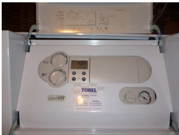
Figure 4: tableau de commande de la chaudière avenue Arbalète 34
