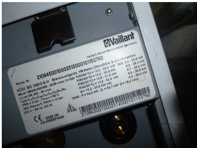
Figure 3: Plaque signalétique de la chaudière rue ibis 5
