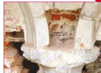
Place Royale. Détail des tirants métalliques insérés dans la maçonnerie de la galerie gothique de l'hôtel d'Hoogstraeten (début 16 e s.), 2006.
