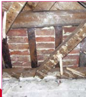
Lakensestraat. Detail van de metalen structuur die de hardvloer van een schouw ondersteunde in het huis Dewez (eind 18e e.), 2008.
