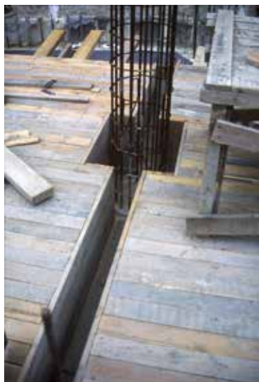
Fig. 9 Détail du ferrailage pour la colonne ronde, 1988-1989 (© AUCL, Faculté LOCI/Fonds Jean Cosse).
