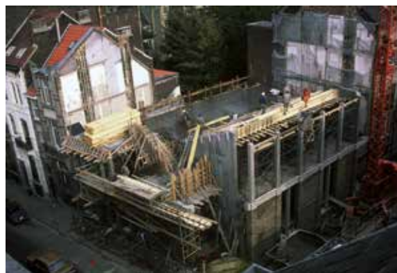
Fig. 15 Les gradins au deuxième niveau en construction, vue panoramique, 1989 (© AUCL, Faculté LOCI/Fonds Jean Cosse).
