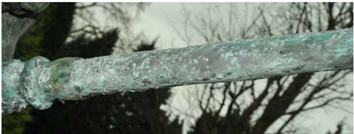
Fig. 11c Corrosion active de l'aluminium (© Metafose).
