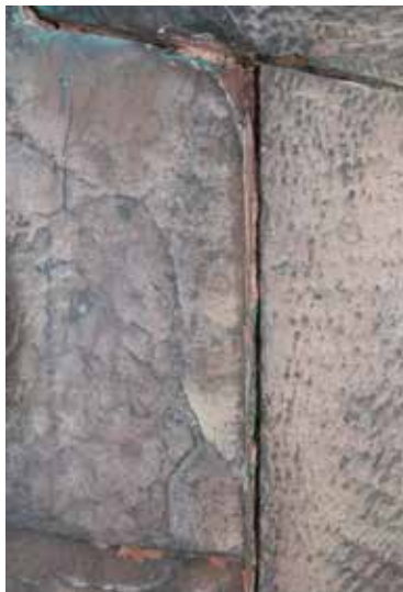
Fig. 2b Oxydation sous les joints rouges récemment enlevés, avant restauration (© AVAPartners).
