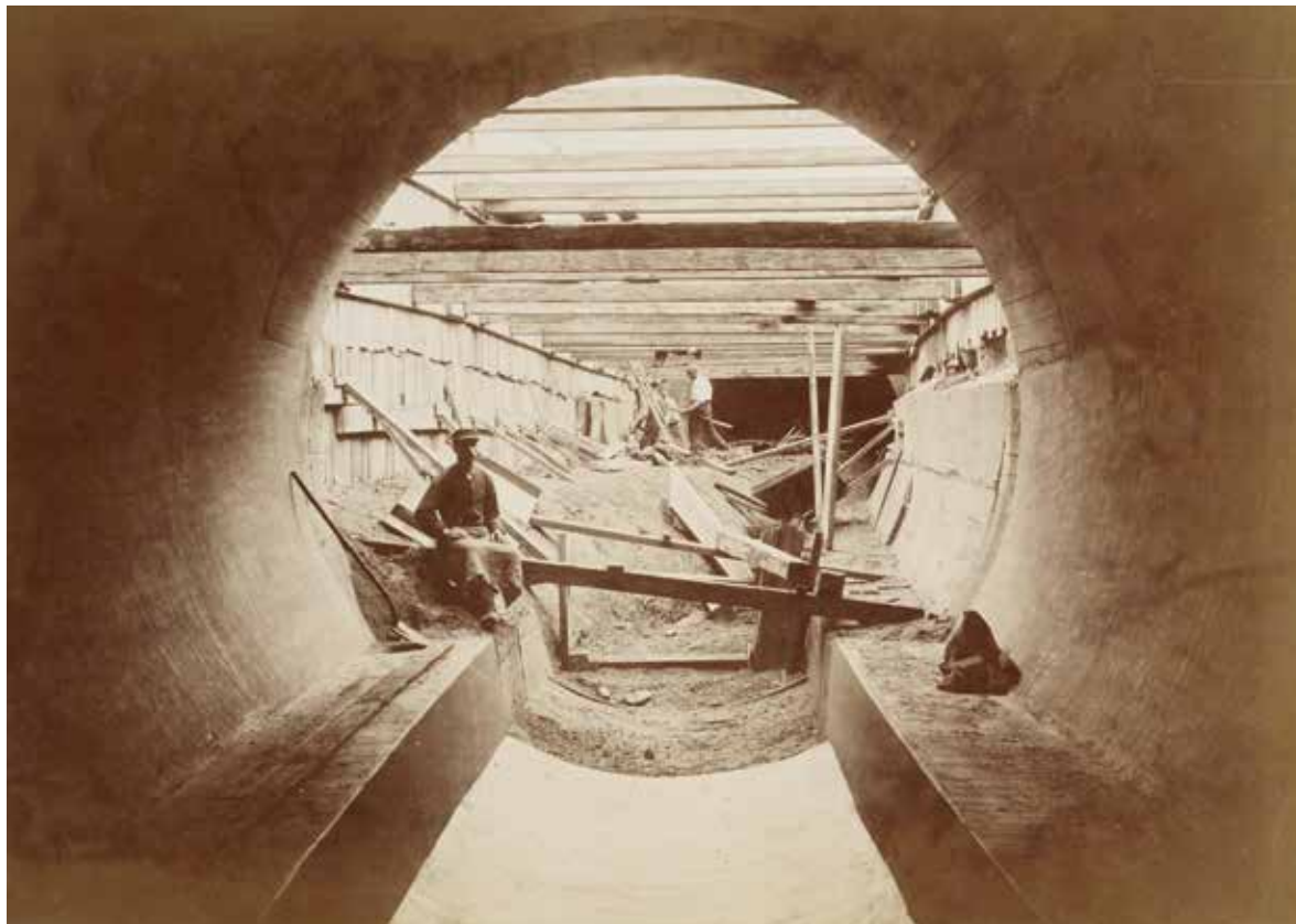
Fig. 4 Travaux d'assainissement du Maelbeek. Photo de chantier collée sur carton (© Fonds Victor Besme).
