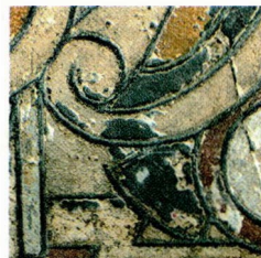
Usure de la surface picturale et de la couche de surface rue Herkoliers 35, Koekelberg
